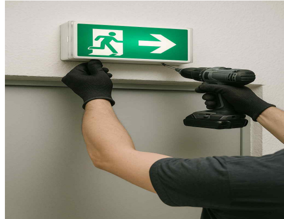
폐쇄된 피난구에 설치된 유도등 철거
